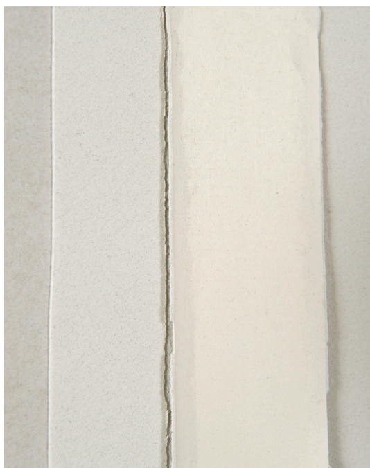
Sparkelremsen løsner fra ytterkanten; kantslipp.
